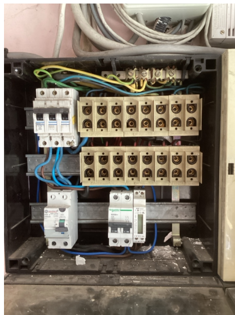
( Elektrisch bord - binnenkant )
